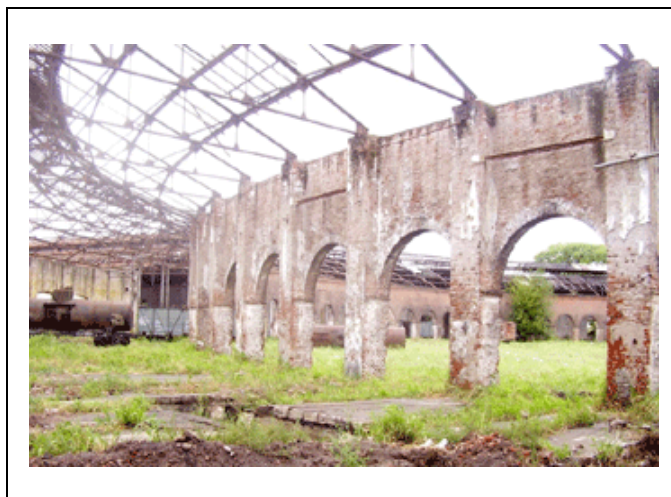
Figura 26 - “La Redonda” en estado de deterioro.
