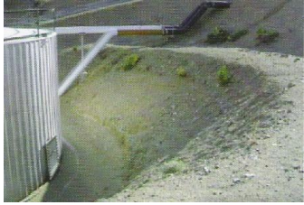
Talud sin geomanta y malla.
