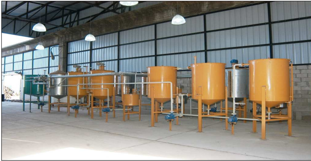
Imagen N° 16: La planta municipal de biodiesel de General San Martín, aún sin inaugurarse, fue diseñada y construida en su totalidad por una empresa privada cordobesa.
