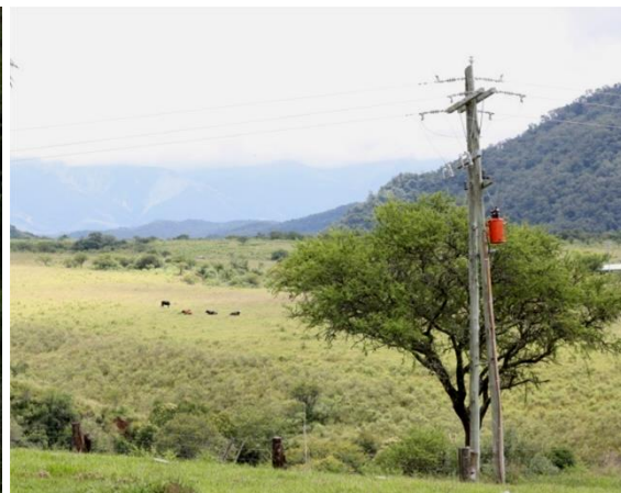
Extensión de la red eléctrica al costado del camino. (Registro propio).
