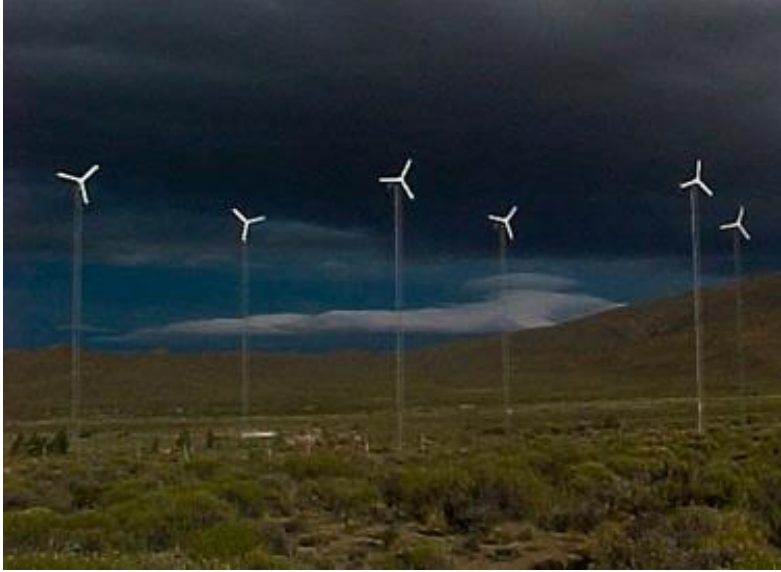
Aerogeneradores en la provincia de Chubut. (Fuente: "Energía Eólica | Jacobone | Energías Renovables")
