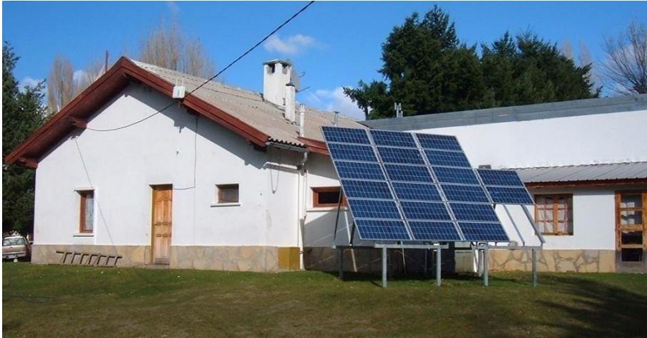
Repotenciación con equipos fotovoltaicos, en una Escuela de Neuquén. (Fuente: Informa n.d.)
