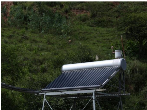
Calefón solar instalado en la escuela 262. (Registro propio).
