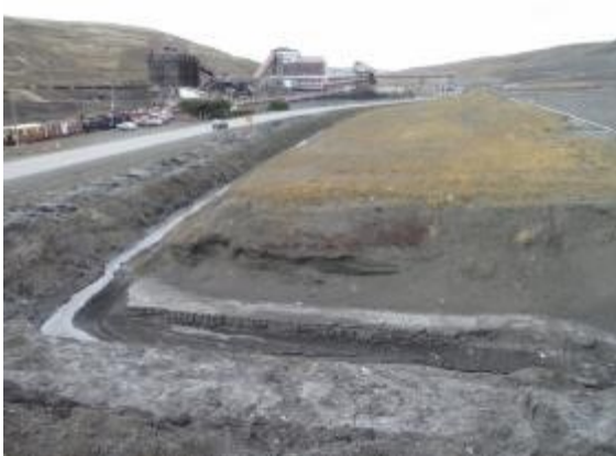
Fig. 17 Canal de efluentes
