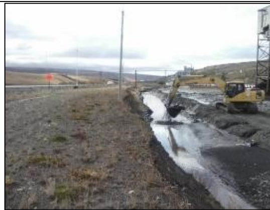
Fig. 15 Limpieza de canal de efluentes de Planta. Se observa gran acumulación de sólidos.
