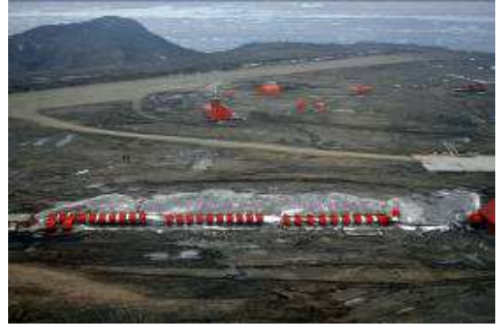
Fig. 15: Batería de cisternas de GOA para la usina de Marambio. Fuente: Autor, 2014.
