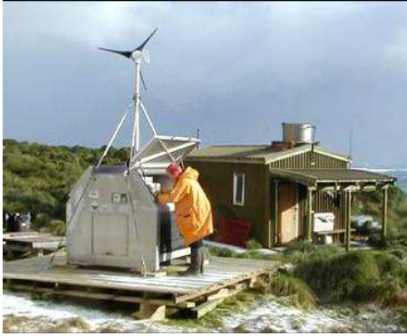
Fig. 24: Vista de un sistema RAPS instalado junto a un refugio subantártico. Fuente: AAD, 2009. http://www.antarctica.gov.au/
