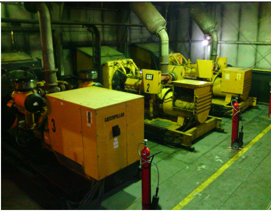
Fig. 17: Interior de la Usina principal de Marambio. Fuente: Autor, 2016.
