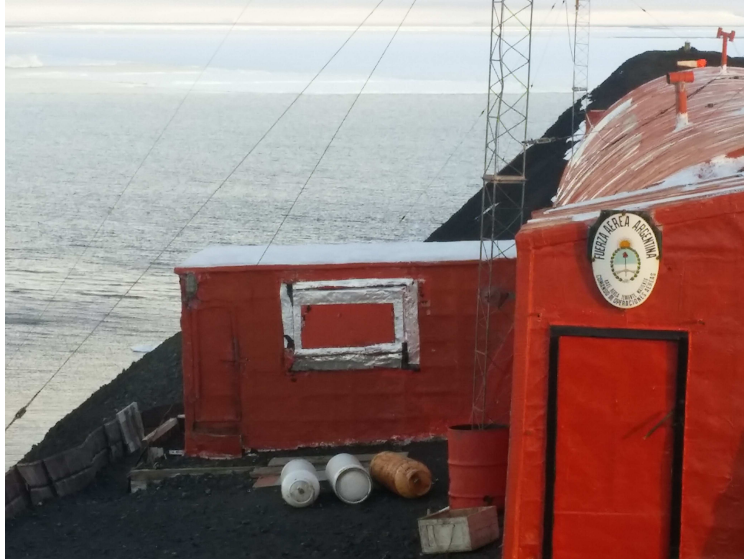
Fig. 43 y 44: Techo sector comunicaciones y techo del derretidor propuestos para ubicación de paneles FV. Fuente: Autor, 2018.
