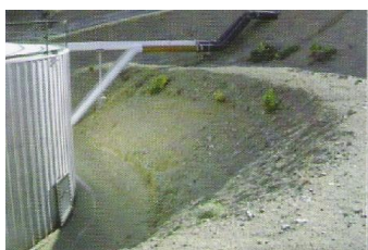
Talud sin geomanta y malla.
