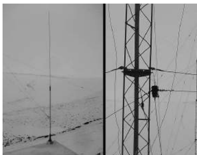
Antenas instaladas por UV para las activaciones.
