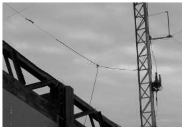
Una de las antenas instaladas por UV.
