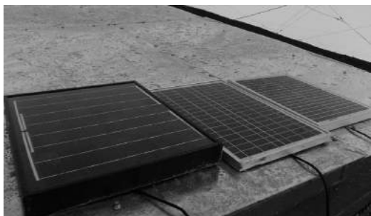
Paneles solares usados por UV.
