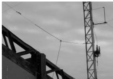
Una de las antenas instaladas por UV.
