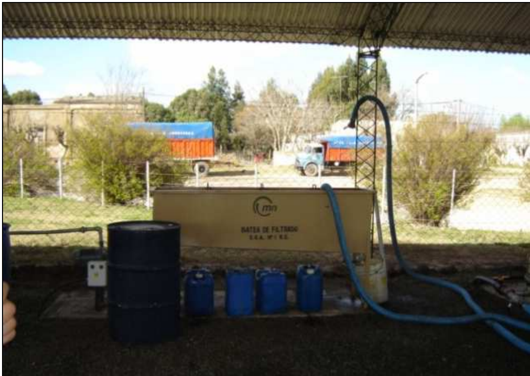
Imagen N° 25: En la imagen se observa la batea de macrofiltrado. La parte inferior con una leve inclinación para facilitar la succión del agua con los restos orgánicos hidratados.
