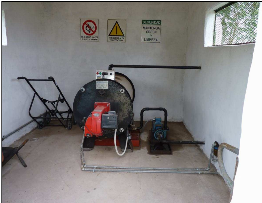
Imagen N° 28: Con un subsidio municipal se incorporó a la planta un nuevo sistema de calentamiento por fluido térmico. Este sistema cuenta con una caldera y un sistema de cañerías y bombas.
