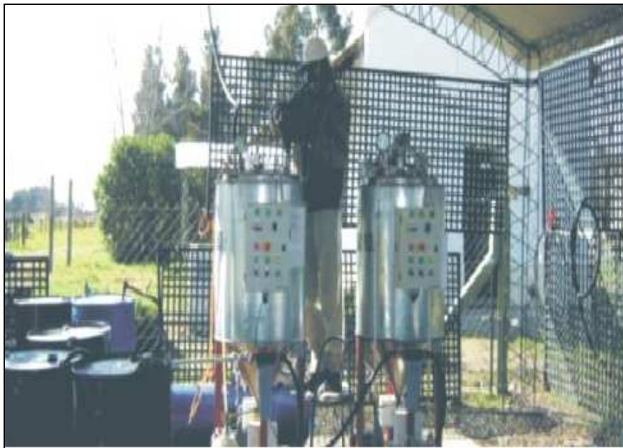
Imagen N° 24: La planta de biodiesel comenzó a funcionar con un reactor y un secador de aceite. Ambos equipos fueron comprados.
